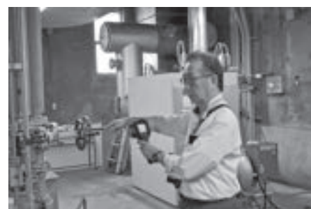
測定器を用いて診断
